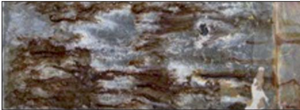
Durchkorrodierte Oberfläche bei 2.000 Stunden Salznebelbelastung eines mit Zinkstaub grundierten Bleches
